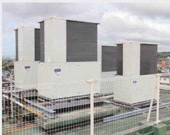
屋上に設置したGHP
