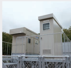
非常用発電機
