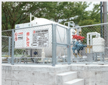
災害バルク貯槽
