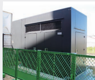
非常用発電機
