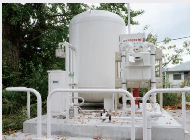
災害バルク貯槽
