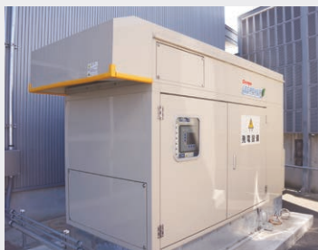
非常用発電機
