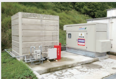
災害バルク貯槽と非常用発電機
