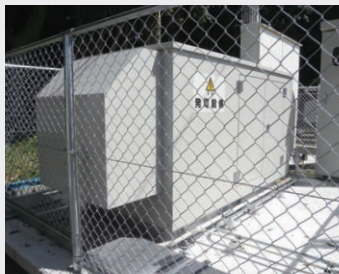
非常用発電機
