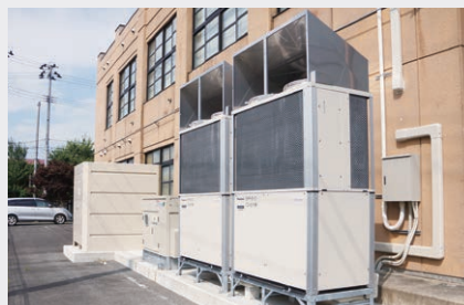
図書室や視聴覚室が入った建物のGHPと発電機、災害バルク貯槽
