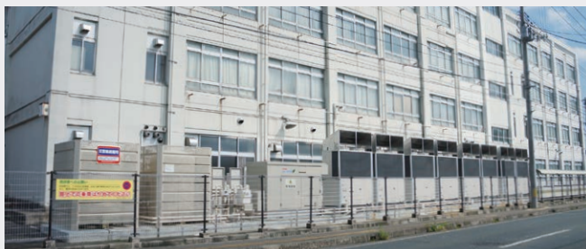
2号館に設置された災害バルク貯槽、発電機、GHP
