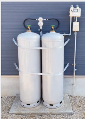
LPガスの軒下在庫
