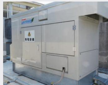
非常用発電機
