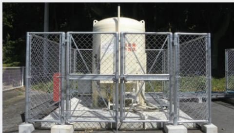
災害バルク貯槽
