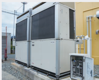
GHPと災害時用ガス栓
