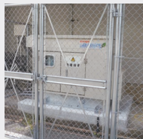
非常用発電機(深日小)
