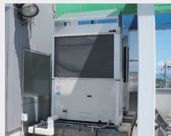
本社屋上に設置したGHP
