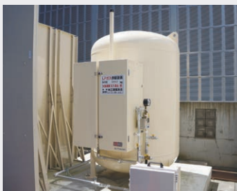
災害バルク貯槽
