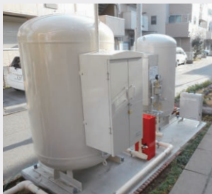
災害バルク貯槽
