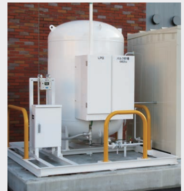
自治体庁舎に導入された災害バルク
